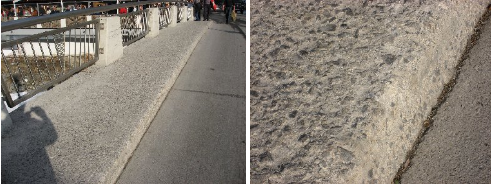
Abbildung 3: Großflächiger Frostschaden an Ortbeton-Brückenkappen
