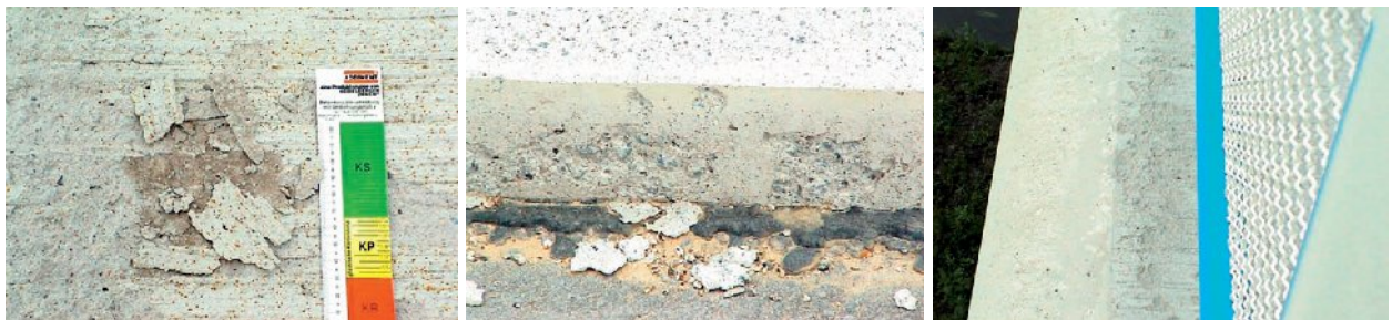
Abbildung 2: Frostschäden an Ortbeton-Brückenkappen: Links: Flächig-blättrige Abwitterung der Kappenoberfläche. Mitte: Abwitterung am Schrammbord. Rechts: Ungeschädigtes, in Schalung hergestelltes Gesims in unmittelbarer Nachbarschaft zur verwitterten, ohne Schalung hergestellten Kappenoberfläche [Quelle: Tauscher, F., Pisarsky, L.: Frostschäden an Brückenkappen , DBV-Rundschreiben 215 - Anlage 2, Berlin 2007]
