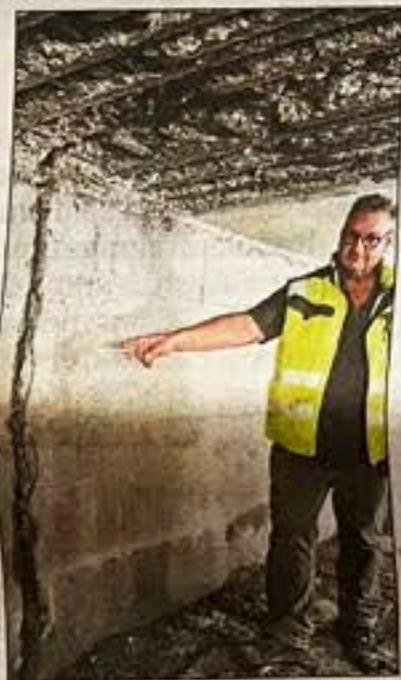
Die Schadstelle an der Decke wird mit Spritzbeton wieder verschlossen, danach kommt ein Spezialgel in die Fuge.
